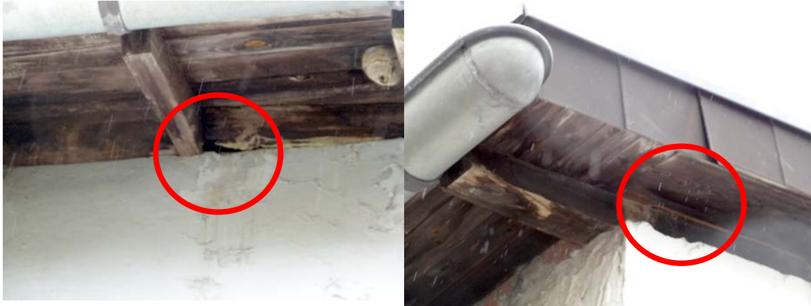
Abbildung 5 a und b: Einflugmöglichkeit an südwestl. Außenfassade
